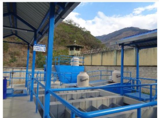
Sistema de dosificación y aplicación de insumos químicos
