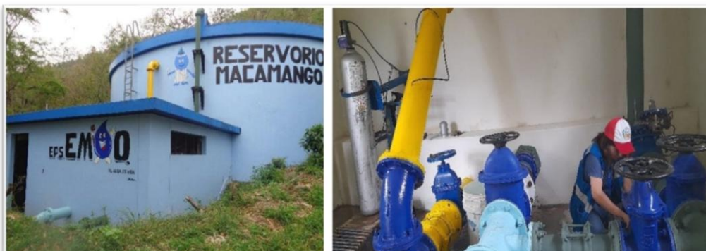
Reservorio apoyado Macamango
